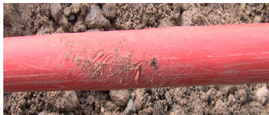
Fig. 10: Ejemplo de cable con defecto en la cubierta
